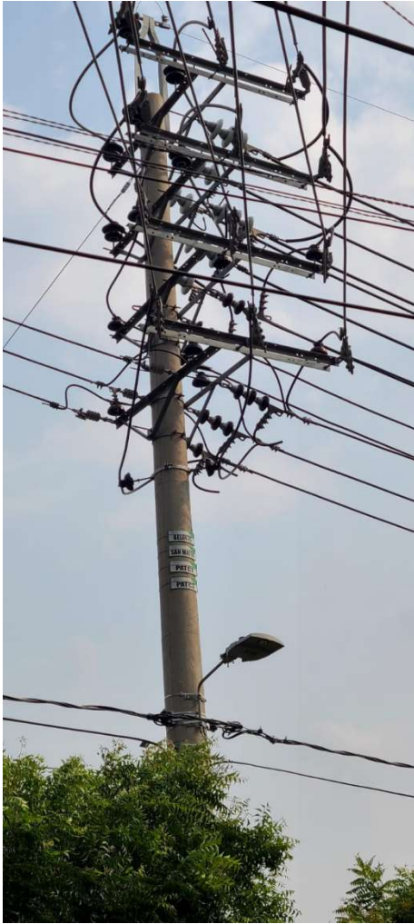
Llegada de la Línea a SE Los Patios
