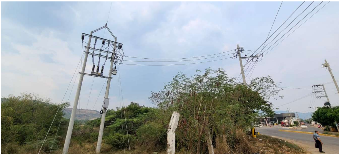
Conexión circuito Cemex a Línea San Mateo – Los Patios
