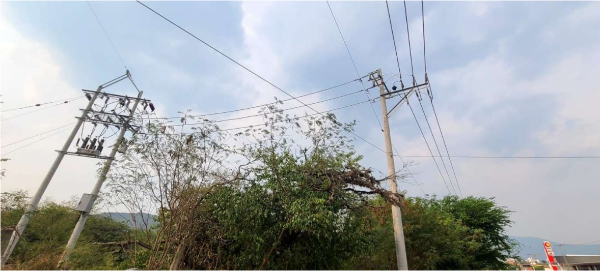
Punto de conexión propiedad de CEMEX
